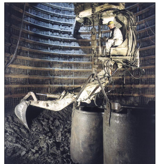
↑ Figuur 5 Constructie van de tweede schacht: uitgraving op industriële wijze in niet-bevroren klei. De tijdelijke bekleding bestond uit TH-profielen.
